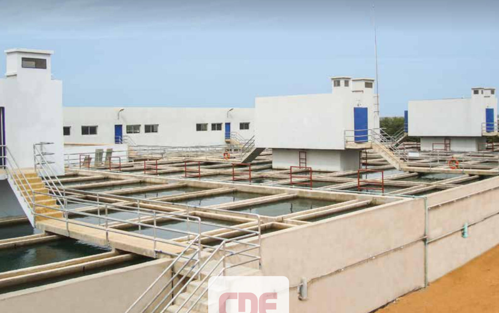
Station de traitement d'eau potable (SÉNÉGAL)
